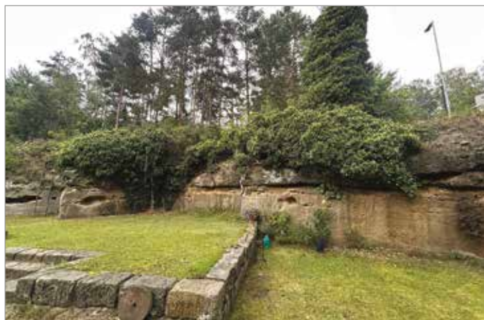
Skalní stěna je v havarijním stavu
